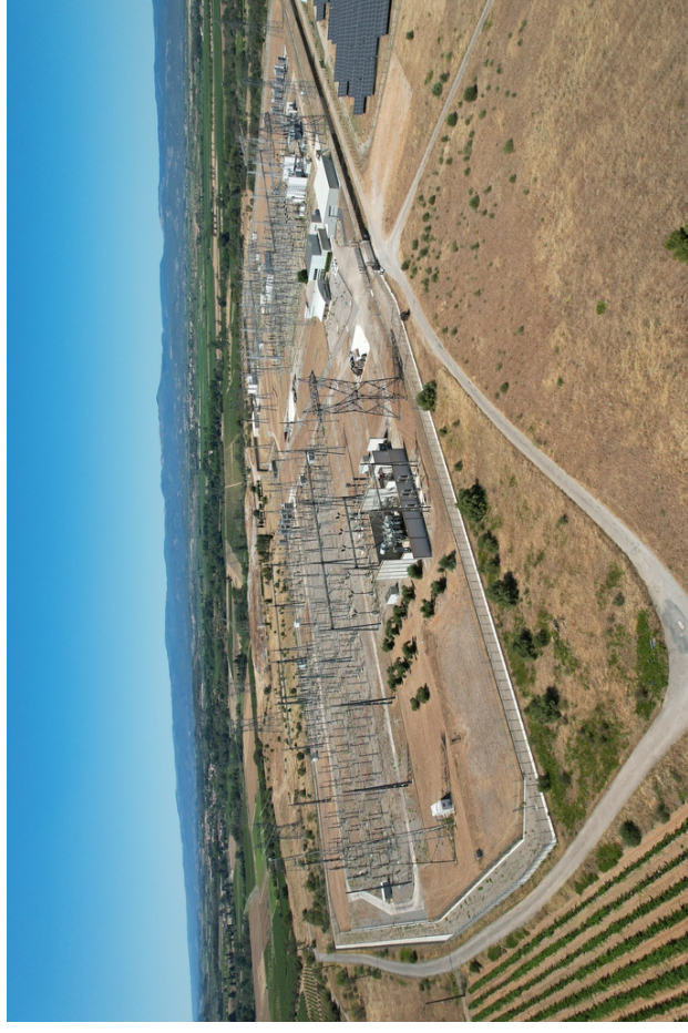
Exemple de poste source local : celui de La Gaudière (Castelnau-d'Aude)
