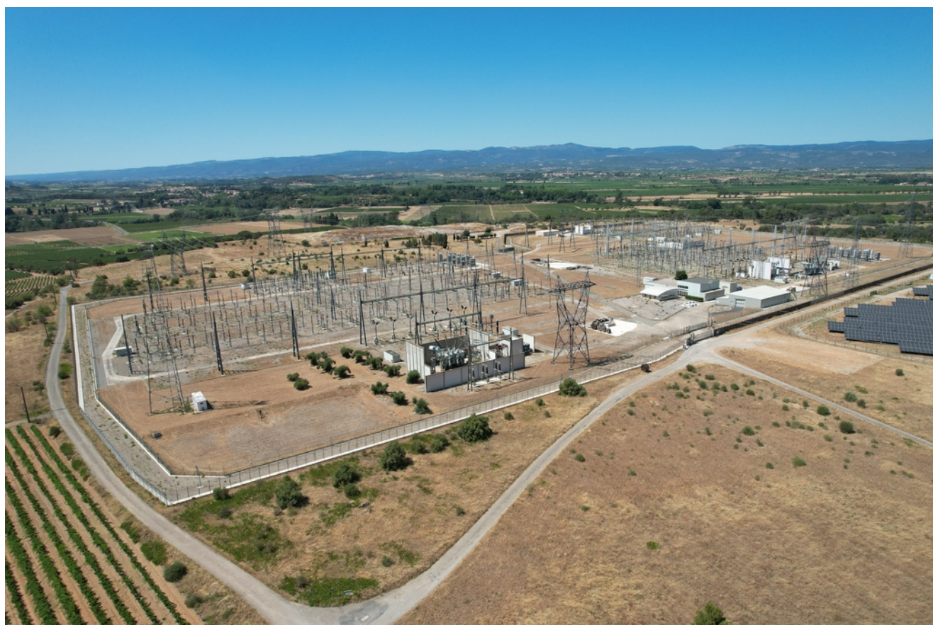
Exemple de poste source local : celui de La Gaudière (Castelnau-d'Aude)
